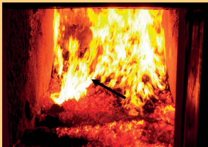
Eccesso di aria con «hotspot» (freccia) e formazione di scorie (ardens GmbH, 2017)
