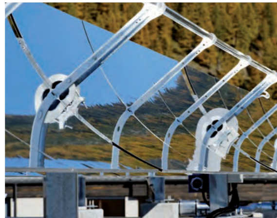
Im Hochsommer decken die Parabolrinnenkollektoren in Saignelégier bis zu 50% der benötigten Wärmeenergie. ©Bild: Solaragentur
