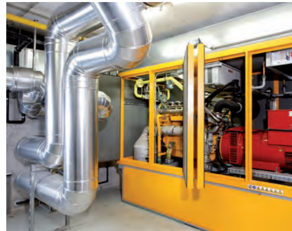
Die 18 Wärmeverbände der ADEV lieferten 2012 rund 11.5 Mio. kWh Wärme und 2.5 Mio. kWh Strom für Einkaufszentren, Schulanlagen, Gewerbe- und Industriebetriebe, Hotels und 450 Wohneinheiten.
