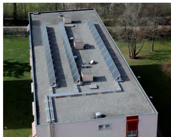
Die Installation einer Vorwärmanlage ist praktisch und unabhängig von anderen Effizienzmassnahmen. Zudem sind das Investitionsvolumen und die Komplexität überschaubar. Bild: Ernst Schweizer AG, Metallbau
