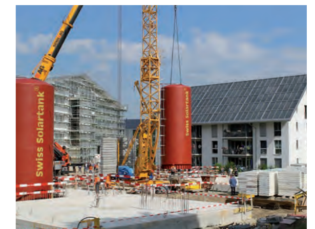
Diese Solarspeicher decken den Ganzjahresbedarf an Warmwasser und Heizung für je acht grosse Wohnungen.
