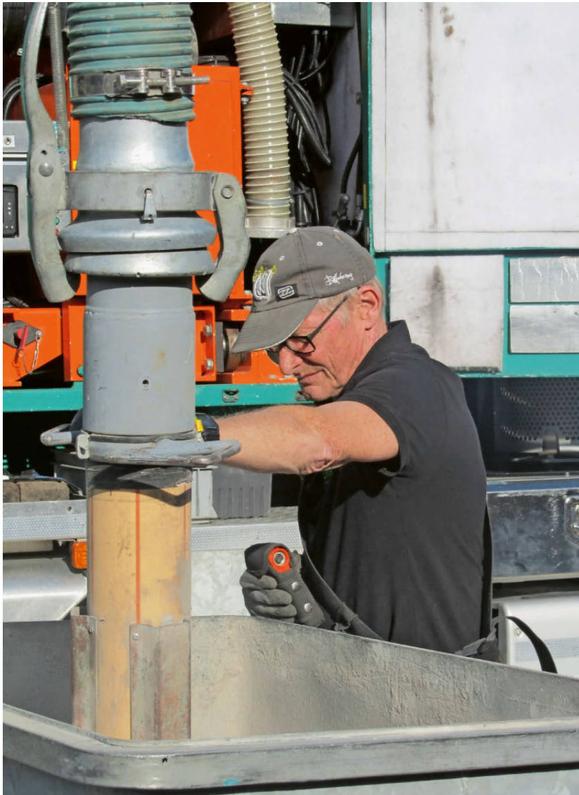
L'aspiration des cendres des bois hors du container se fait sans la moindre production de poussières.
